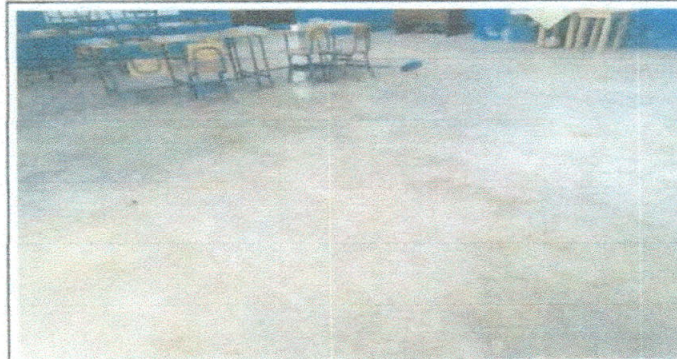
Foto 4: Se observa en la fotografía el deterioro del piso del aula.
