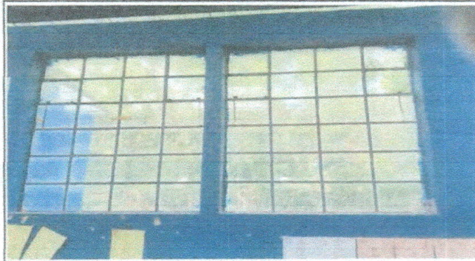
Foto 2: Se observa en la fotografía el deterioro del vidrio de las ventanas de la escuela.
